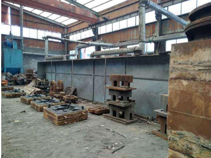
浇铸废气收集装置
